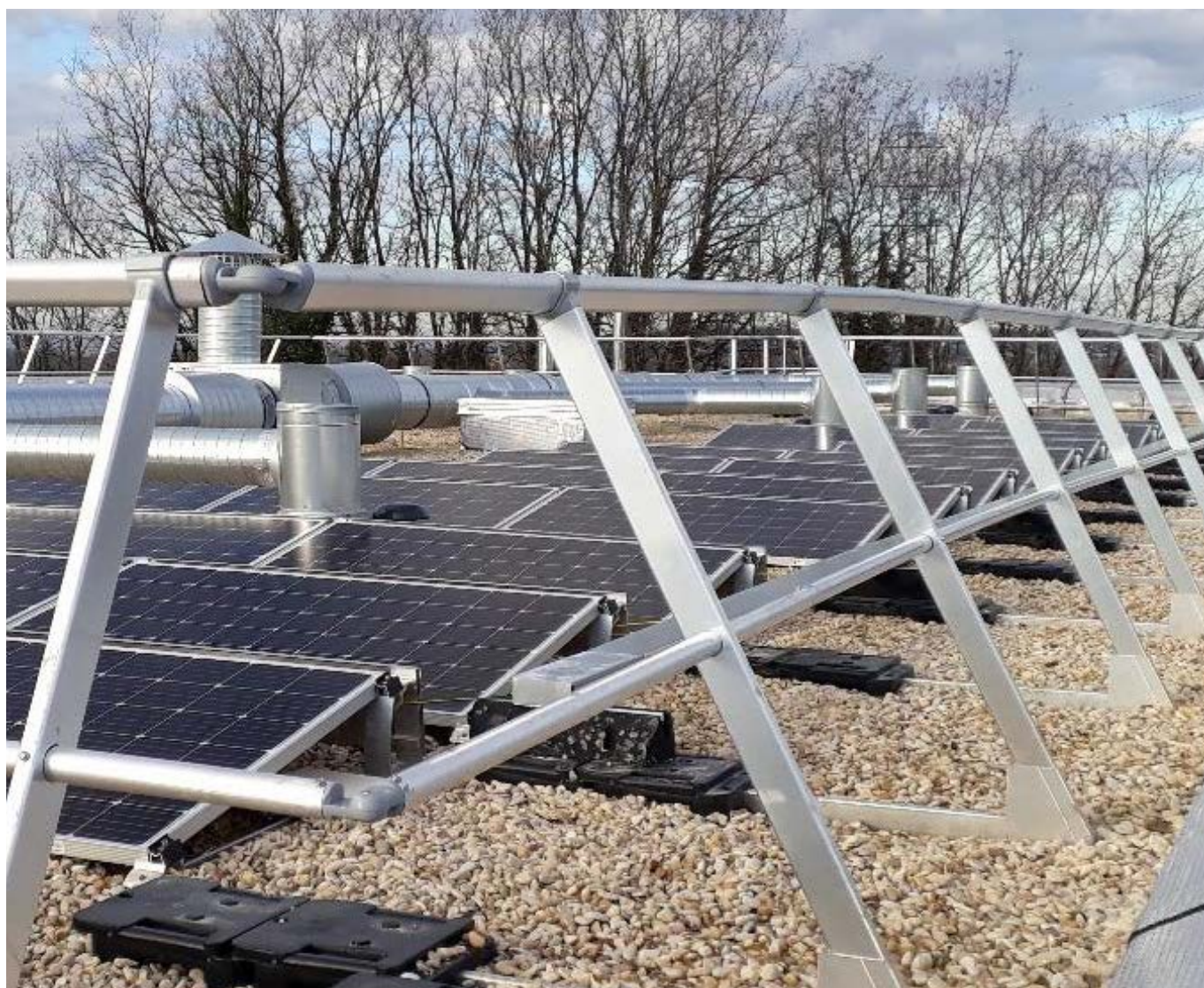
Panneaux photovoltaïques installés sur un programme réhabilité, rue du Sanatorium à Besançon, contribuant à l'alimentation électrique des locataires et des parties communes.
